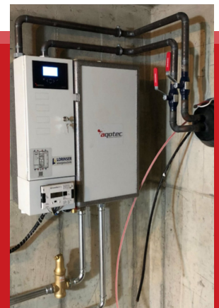
Übergabestation im Haus
